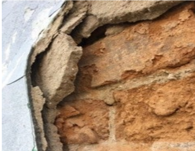
Фото 3. Руйнування цегли під цементним розчином
