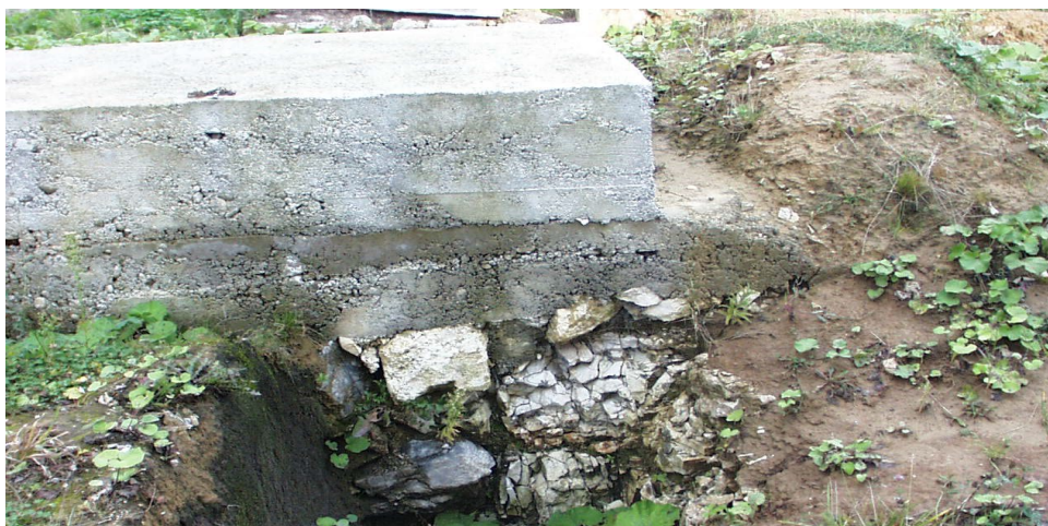
Рис. 1. Деструкція історичних блоків крейдяного вапняку при контакті з бетонними розчинами.
