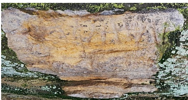
Фото 4. Експериментальна ділянка № 1 (аварійна) на стелі гроту, Поверхня розчищена від щільного шару пліснявих грибів та законсервована у 2012 р.
