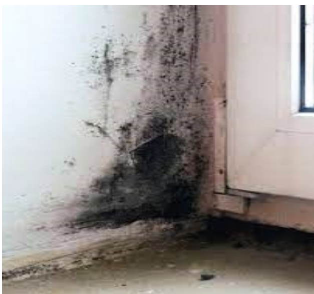
Фото 2. Ураження цвільовими грибами ( Aspergillus ) зовнішнього кута приміщення на вологій стіні
